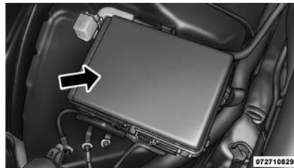
Centro de distribución de tensión delantero
