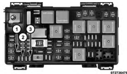
Caja de fusibles debajo del capó
