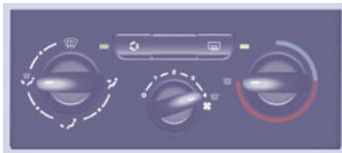
Frontal de la calefacción
